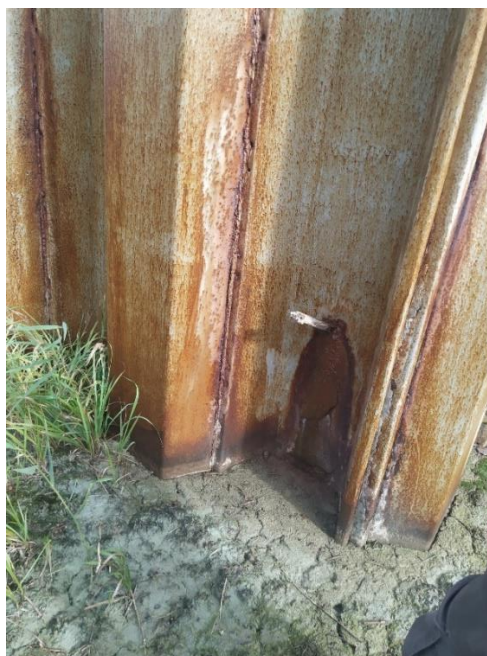
Фото 12. Некорректный ремонт течи в металлическом экране карты – имеются протечки за пределы карты
